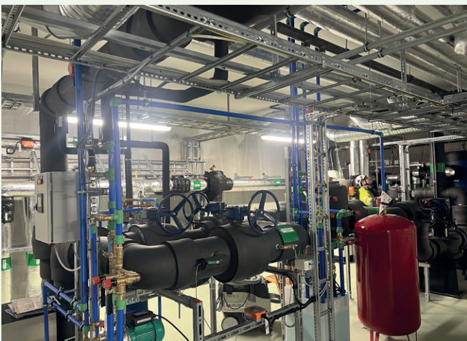
Fra teknisk rom.
